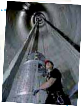
Im Turm einer Windenergieanlage
