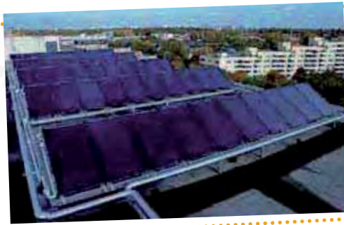
Sonnenkollektor auf einem Hausdach
